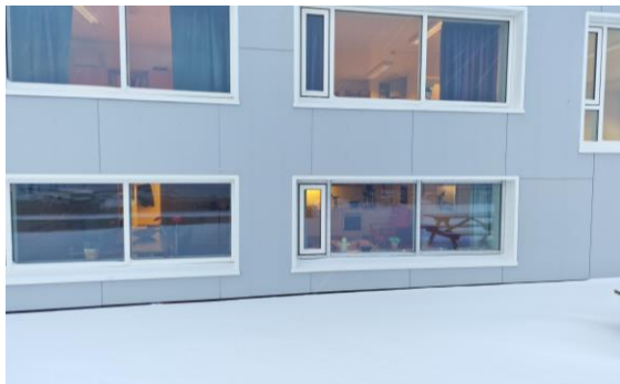
Mynd 11. Framhlið hússins, búið er að klæða með álkerfi og endurnýja glugga.
