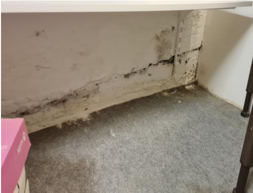
Mynd 2 rakaskemmd í útvegg í geymslu kjallara.
