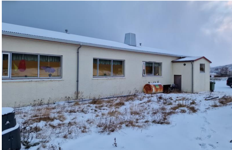
Mynd 5. Jarðvegur liggur upp að bakhlið húsanna
