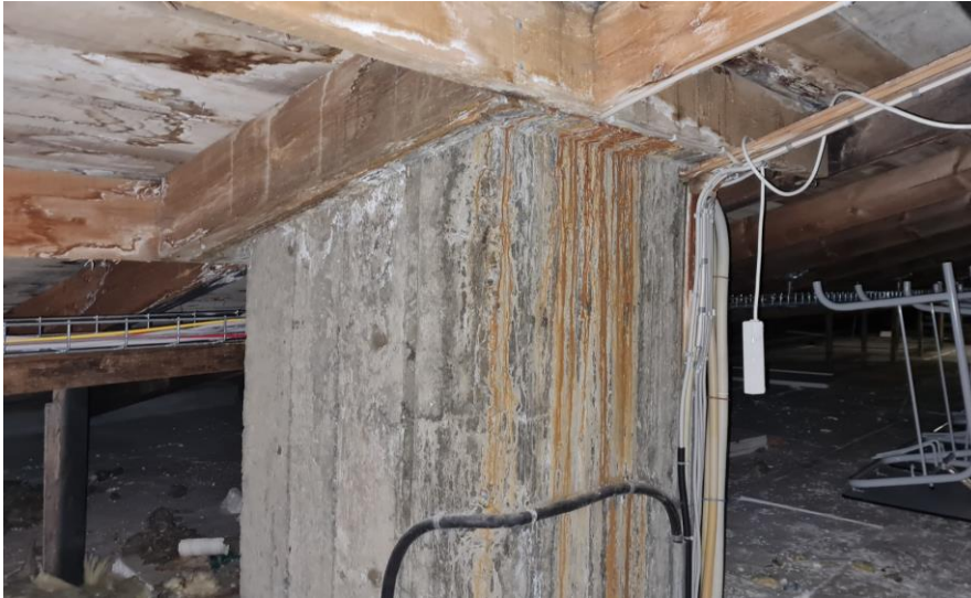
Mynd 4. Lekið hefur meðfram skorsteini á eldri hluta.
